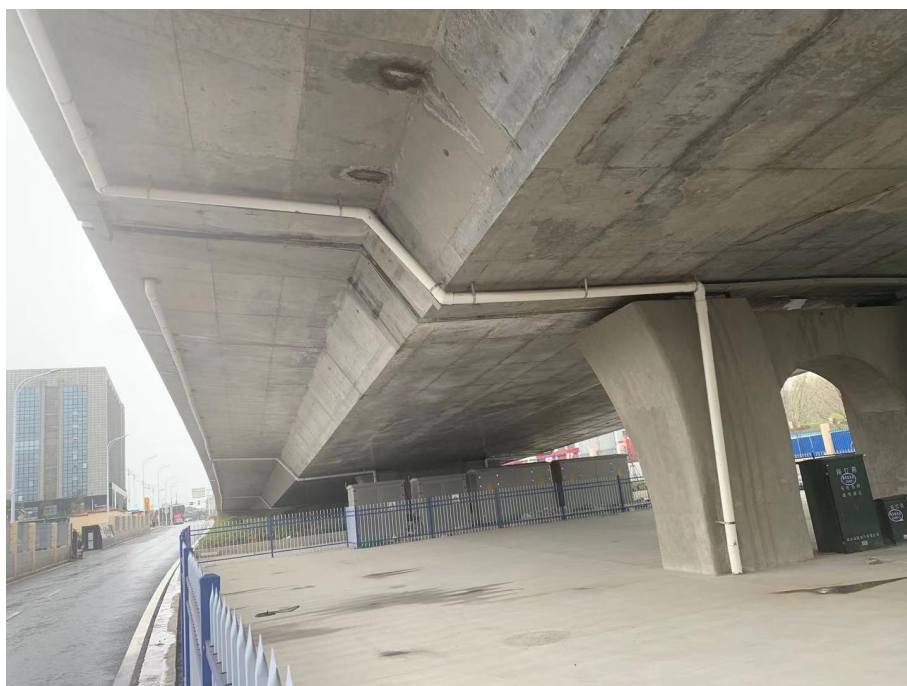
图 5.4-3 项目桥面径流收集系统
