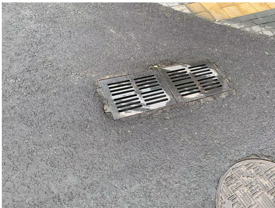
图 5.4-1 项目路面排水情况
