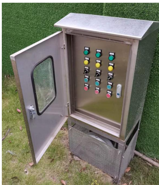
图 8.2-1 龙潭站污水站控制器照片
